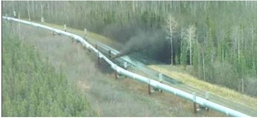
Gambar 2 Pipa yang mengalami burst .
