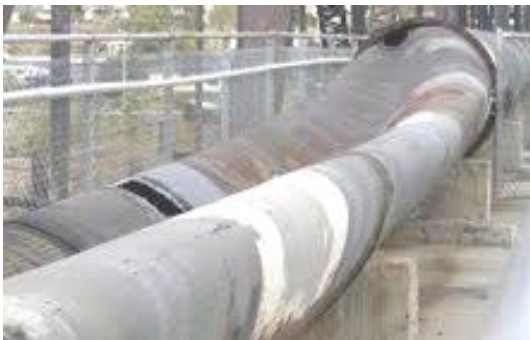
Gambar 3 Pipa yang mengalami collapse .
