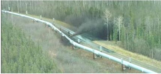
Gambar 2 Pipa yang mengalami burst .
