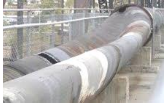
Gambar 3 Pipa yang mengalami collapse .
